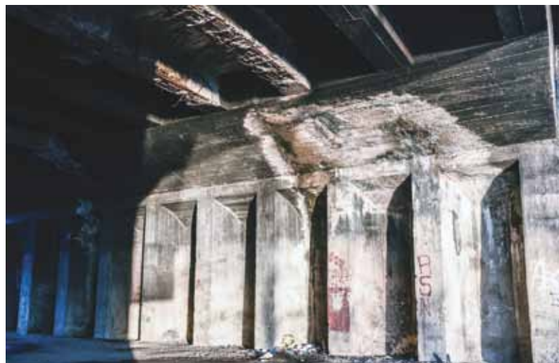
POHLED NA LIBEŇSKÝ MOST zespodu dosvědčuje jeho dezolátní stav. Foto Miloš Skácel
